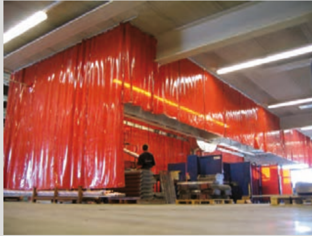
Folienvorhänge in RT (Rot, transparent) an Rohr mit Metallhaken befestigt.
